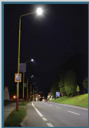
Zkušební LED osvětlení - 80 W.
